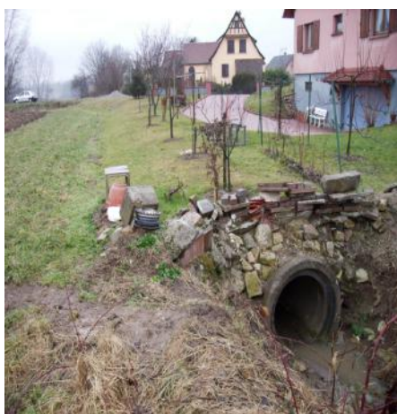
Figure 3 : Inondation du sous-sol de la maison à proximité de l'exutoire
